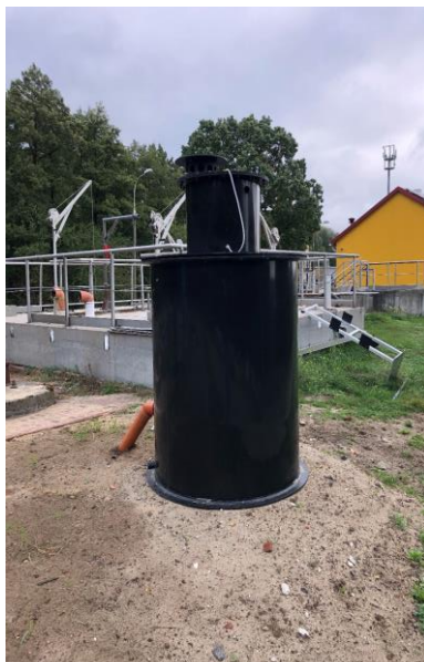
Fot. 4. Biofiltr do dezodoryzacji powietrza złownego komory uśredniania ścieków surowych.
