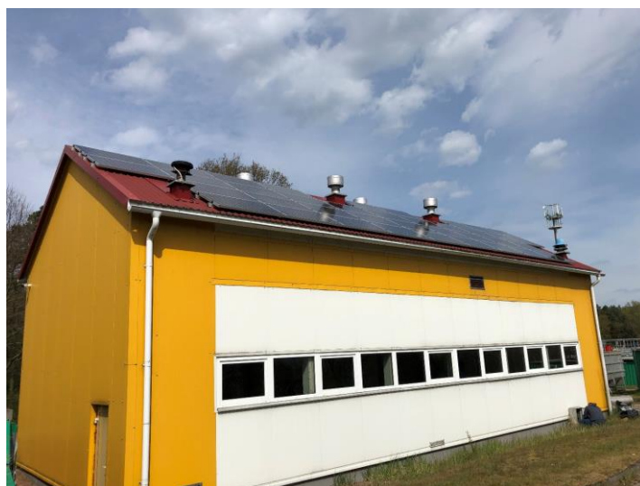
Fot. 5. Instalacja fotowoltaiczna na dachu wiaty kratopiaskownika
