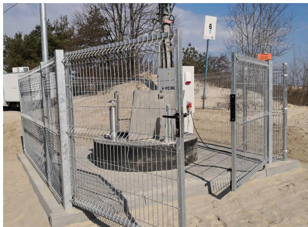
Fot. 7. Przepompownia ścieków przy ulicy Bursztynowej
